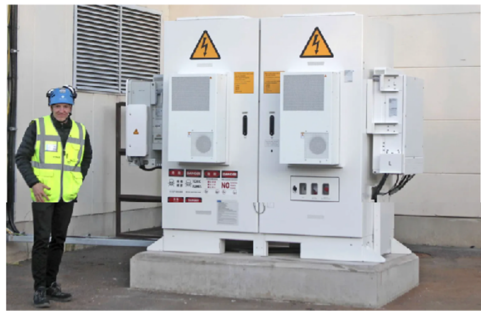
Puskurina. Riihimäelle Alu-Relecon rakennettu sähkövarasto on Huaweiin valmistama. Se pystyy varastoimaan 200 kWh energiaa. KUVA: SOLARVOIMA
